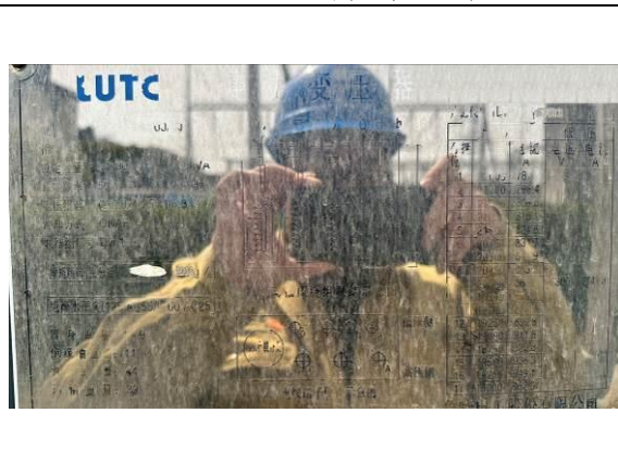
图 3-22 1C#高厂变铭牌
