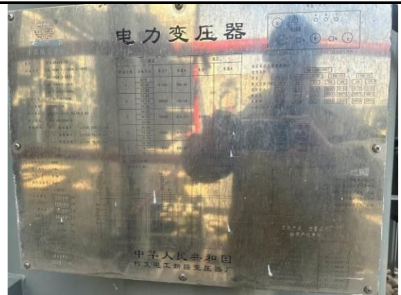
图 3-26 2B#高厂变铭牌
