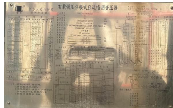
图 3-14 1A#启备变铭牌
