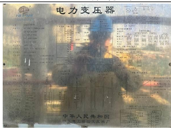
图 3-20 1B#高厂变铭牌
