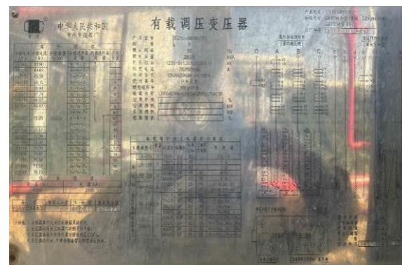
图 3-16 1B#启备变铭牌
