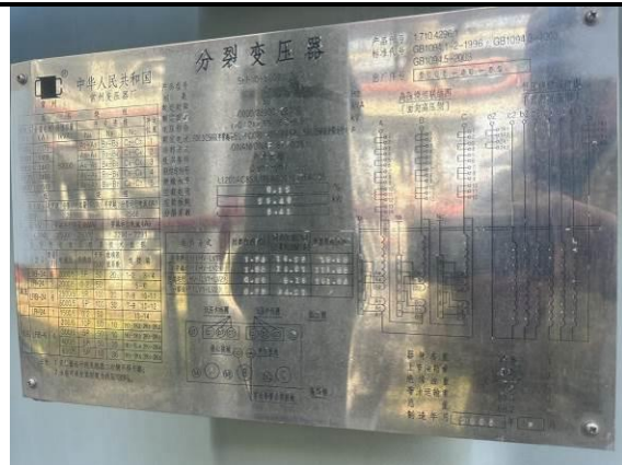
图 3-18 1A#高厂变铭牌
