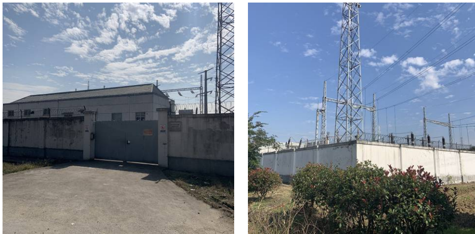
图 3-1 京沪高速铁路无锡牵引变电站实景图
