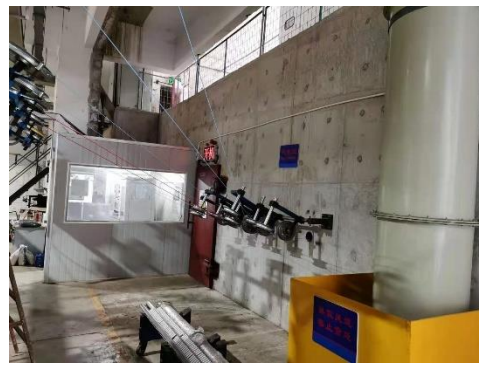
图 8-4 西侧沃尔核材加速器机房
