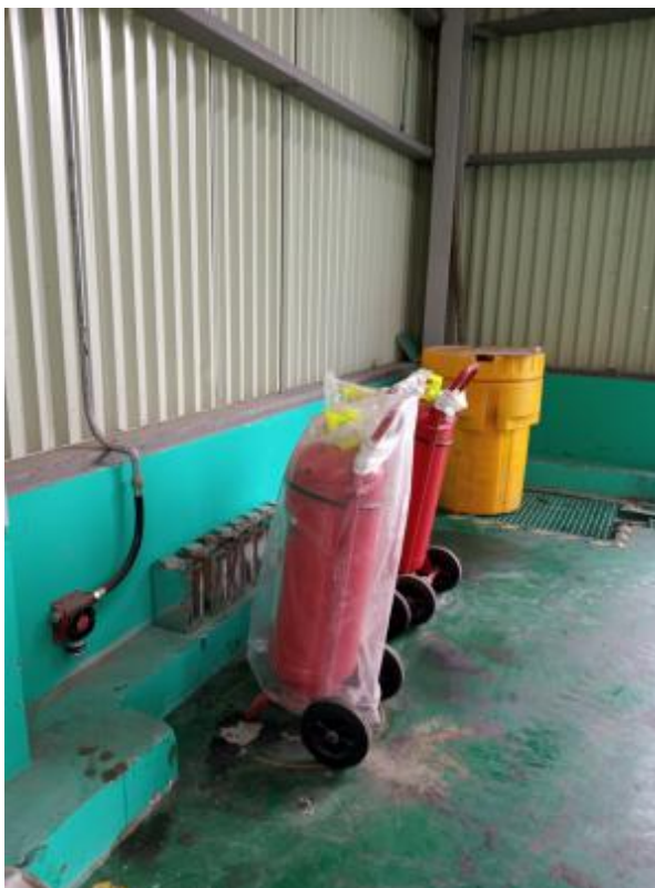
图 4-3 1 号仓库防治情况（消防、应急、集液槽、报警装置）
