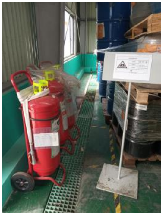
图 4-5 2 号仓库防治情况（消防、应急、导流沟、集液槽）
