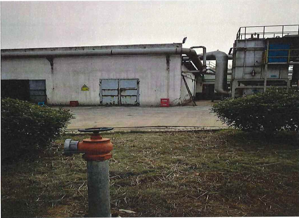
图 1 综合危废仓库周边的消防设施
