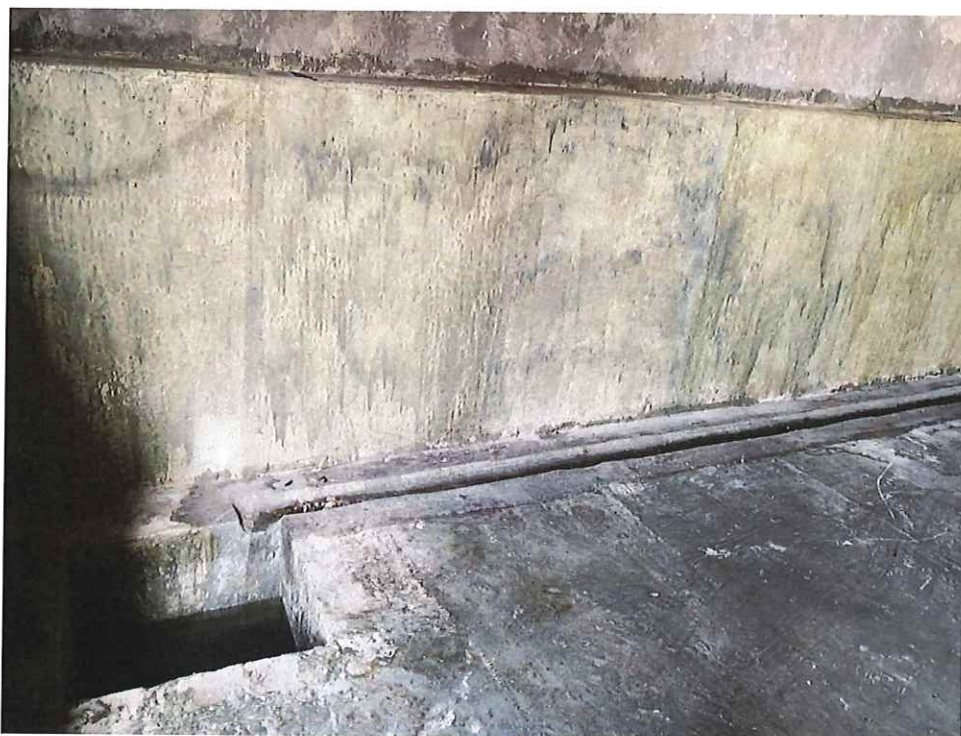
图 3 导流沟及收集槽
