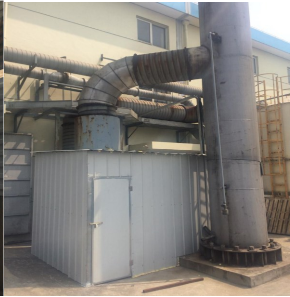
图 4-4 车间三风机密闭（经整改）
