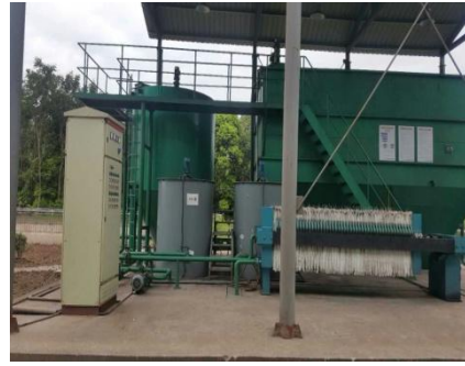
混凝、沉淀、压滤装置
